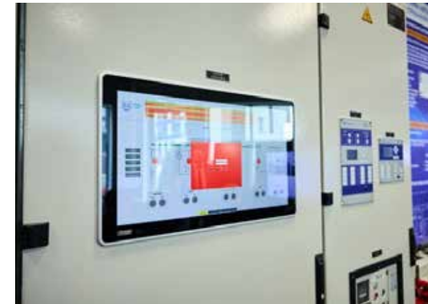
Цифровая комплектная трансформаторная подстанция
