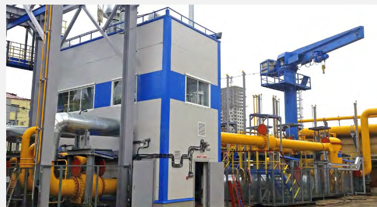
ГРП-2 для ТЭЦ-9 филиала ПАО «Мосэнерго»
