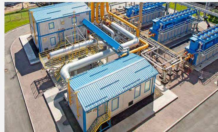
ППГ-ГРП ВД для ЭС-1 Центральной ТЭЦ, г. Санкт-Петербург
