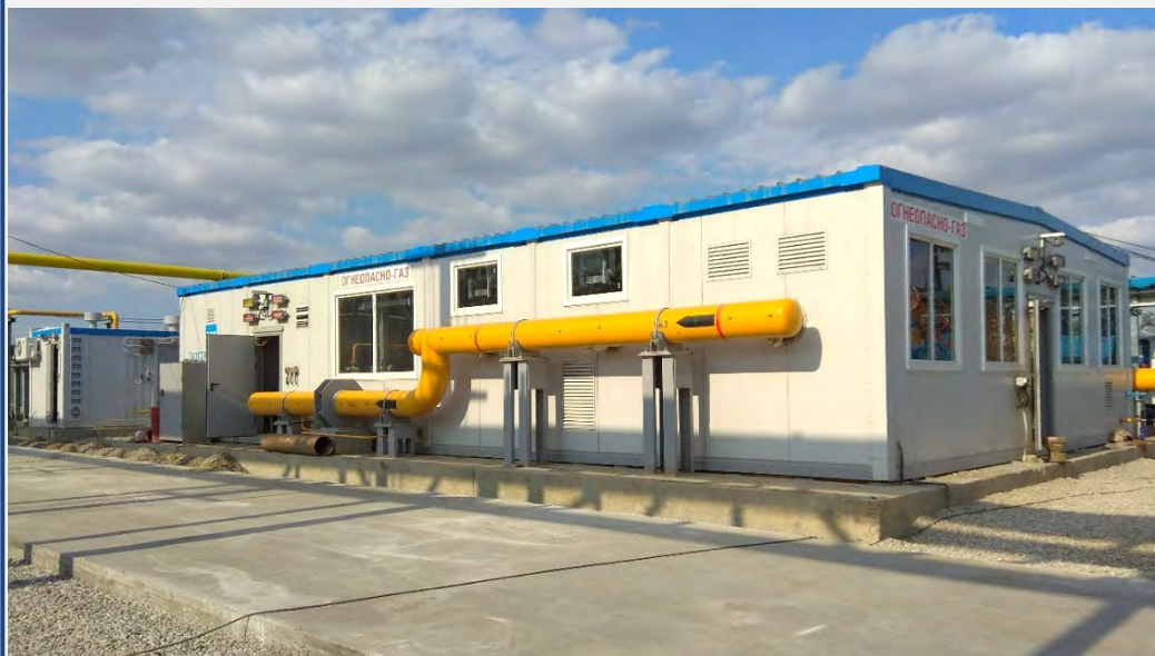
Блочный пункт подготовки газа для Грозненской ТЭС
