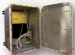
Станция катодной защиты во взрывозащищенном исполнении
