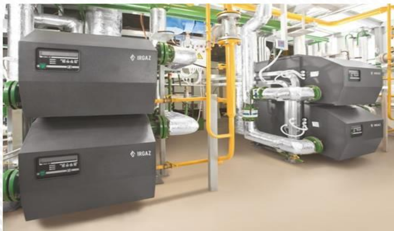
Котлы КВГ-0,2-115 производства ЗАО «Уромгаз» В составе блочно-модульной котельной.
